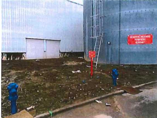
Réservoir aérien de 400 m 3 avec poteaux d'aspiration
