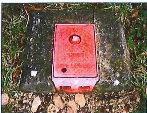
Bouche de lavage fermée
