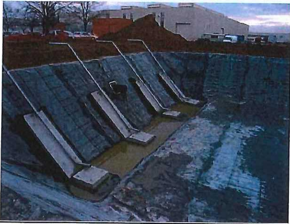
Réserve incendie 1500 m 3
