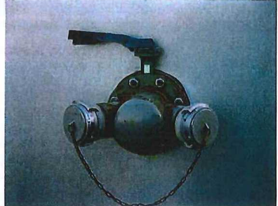
Prises directes de 100 mm sur réservoir aérien
